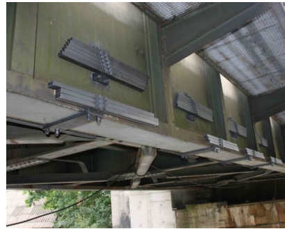
absorbeur sur platelage
